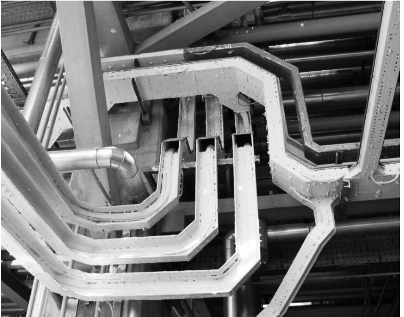
TRIA PYROSAFE FLAMOTECT-A aplicado sobre cablagem em esteira.
